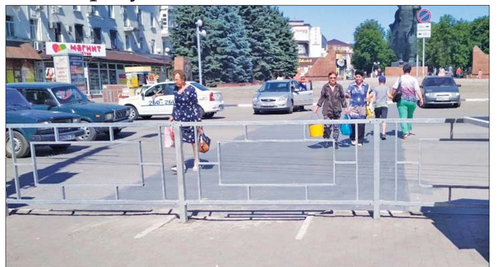
Пешеходный переход на площади Солдата демонтировали и поставили ограждения. Фото Александра Коломоец.
