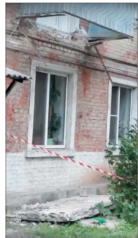
Дом, в котором обрушился балкон, признан аварийным.
