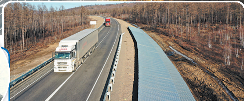
Солнцезащитный навес для земляного полотна дороги в зоне вечной мерзлоты (558-й км Р-297 «Амур»).
