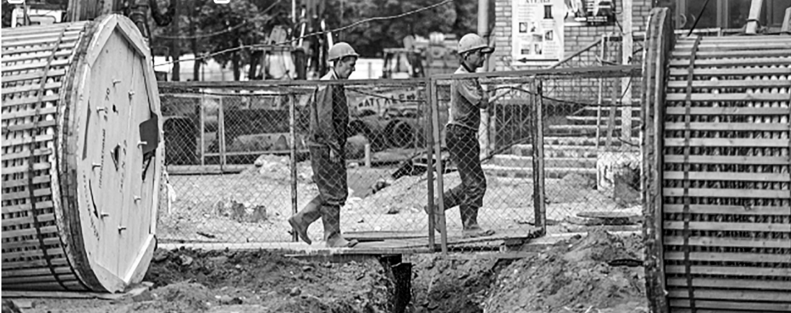
Объекты, расположенные над теплотрассами, затрудняют их ремонт и сами находятся в зоне риска.
