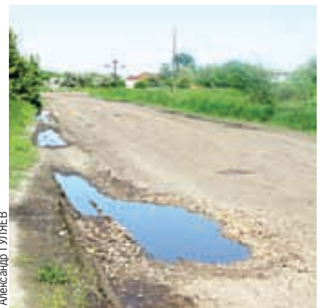
Разбитая дорога на въезде в поселок Алексеевский.
