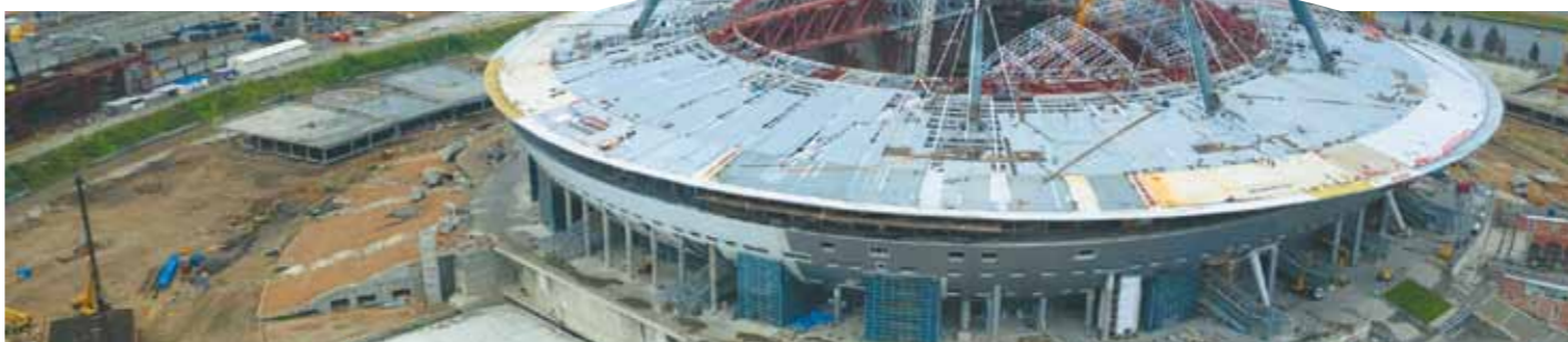
«Зенит Арена», которая примет матчи ЧМ-2018, откроется 27 мая 2016 года. На данный момент завершено 75% работ. Стадион сможет работать 8 часов в автономном режиме в случае обрыва внешних коммуникаций.
