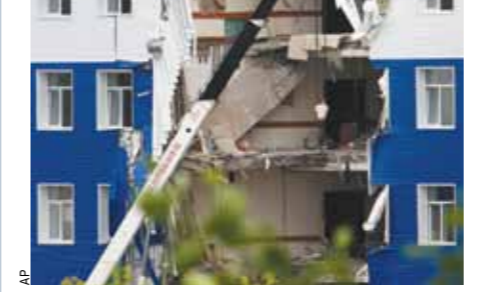
Во избежание подобных трагедий Минобороны приняло решение приступить к проверке технического состояния зданий, сооружений, состоящих на балансе и используемых личным составом в повседневной деятельности. Обязательным и главным для приемки зданий после ремонта и по окончании строительства будет глубокий инструментальный контроль устойчивости зданий. Будет определен и перечень организаций, которые могут быть привлечены к такому контролю.
