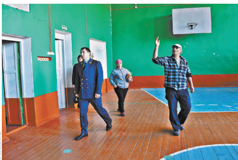
В спортзале с потолка сыплется песок. Вернее раствор, который должен был скреплять бетонные плиты. Заниматься здесь опасно. Может все рухнуть.
