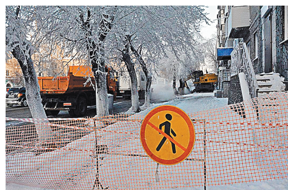
Из-за потоков кипятка в Барнауле пришлось на целый день перекрыть центральный проспект.
