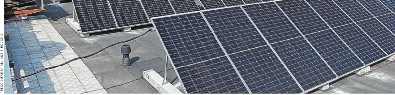
Батареи установили на шестизэтажном офисном здании в центре Москвы, на Озерковской набережной.
