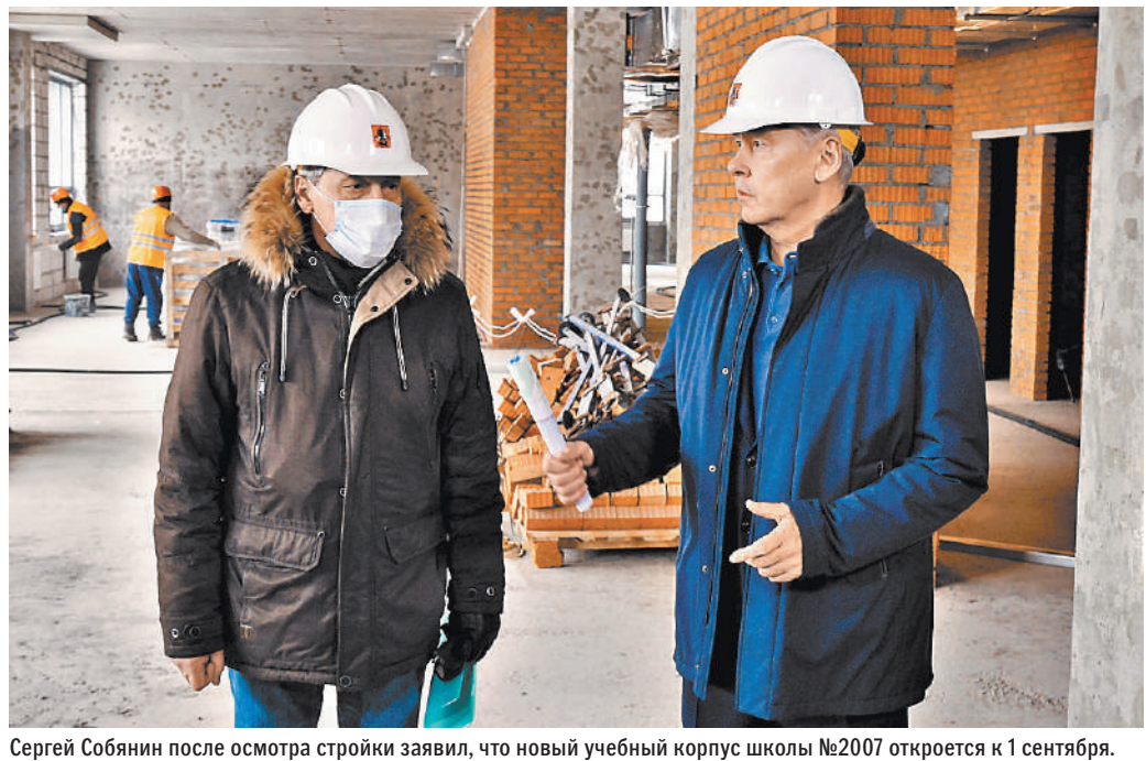
Сергей Собянин после осмотра стройки заявил, что новый учебный корпус школы №2007 откроется к 1 сентября.
