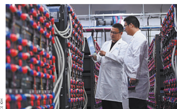
Технические специалисты проводят техобслуживание энергосистемы в центре облачных вычислений в городском округе Сяньян (Центральный Китай).
