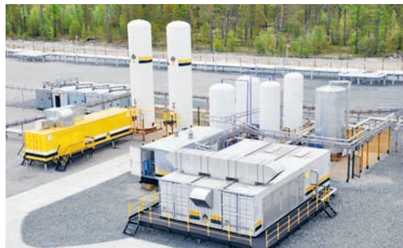
Компрессорная станция Комсомольского месторождения в ЯНАО оборудована по последнему слову техники.
