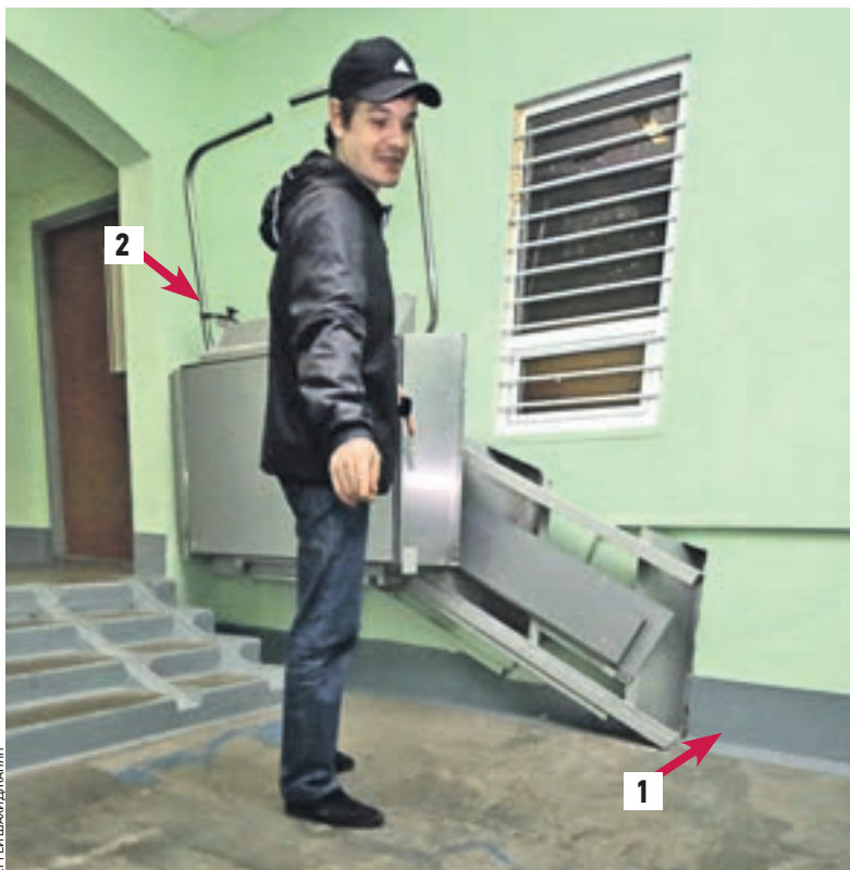
1 октября 18:30 Павел, житель дома № 13 на Рогожском Валу, показывает: голый цементный пол, где должна быть плитка. Стрелками обозначены свешенный кант на стене (1) и подъемник для инвалидов, прикрученный стальной проволокой (2)
