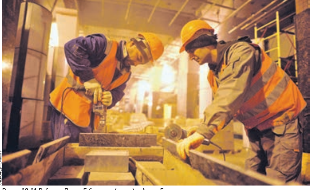
Вчера 12:11 Рабочие Левон Габриелян (слева) и Арсен Бутов готовят плитку для крепления на колонну на станции «Петровский парк» Третьего пересадочного контура метро
