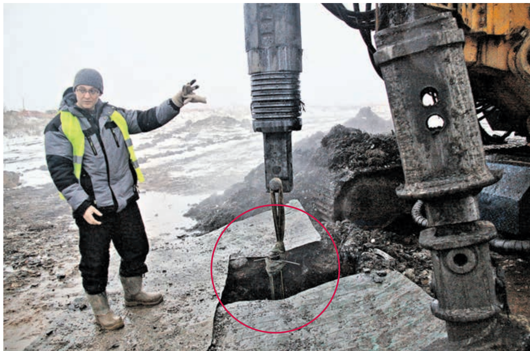
14 декабря 09:15 Полигон «Кучино». Начальник участка по дегазации Павел Семенов демонстрирует процесс бурения скважины для установки фильтратонных труб и откачки газа из недр полигона. Именно из таких скважин исходит неприятный запах, который беспокоил москвичей и жителей области в последнее время
