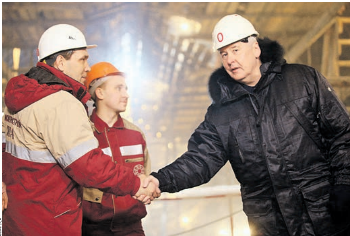
19 января 11:20 Мэр Москвы Сергей Собянин (справа) поблагодарил двух Сергеев Матросовых. Отец и сын — Сергей Евгеньевич (жимет руку градоначальнику) и Сергей Сергеевич в составе большой бригады возводит «Нижнюю Масловку» на глубине 65 метров
