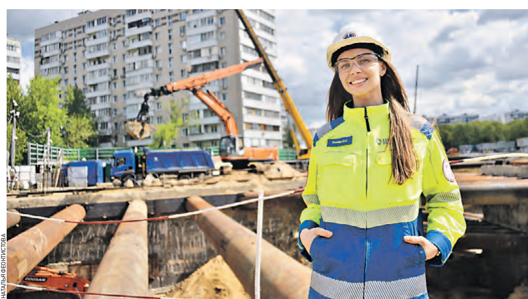
14 мая 2022 года. Представитель строительной компании Юлиана Полева проверяет соблюдение правил охраны труда во время работ на станции «Кленовый бульвар»
