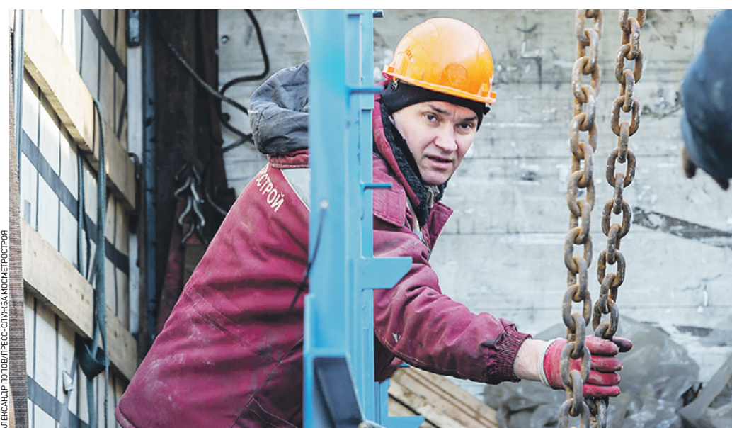
8 апреля 8:35 Рабочий Мосметростроя Иван Комаров помогает спускать детали эскалаторов на станцию «Марьяна Роща» Большого кольца метро
