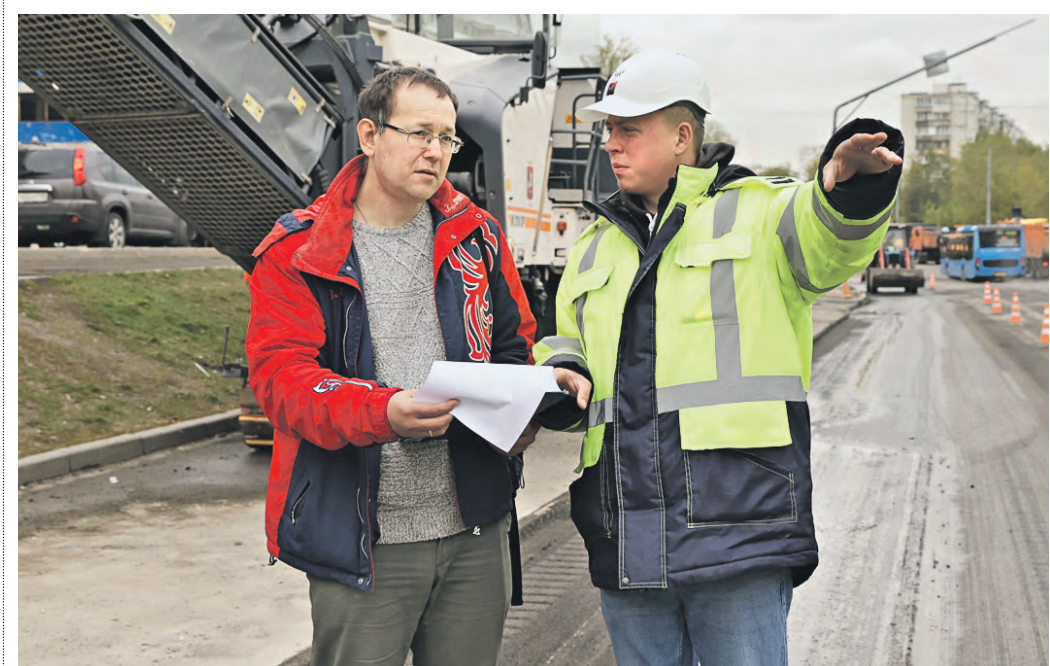
14 мая. Муниципальный депутат района Орехово-Борисово Южное Максим Демченков (слева) с заместителем начальника участка асфальтирования № 2 ПК «Некрасовка» Айратом Яруллиным осматривают ход работ по ремонту дороги на Домодедовской улице. Фото: Анатолий Цымбалюк
