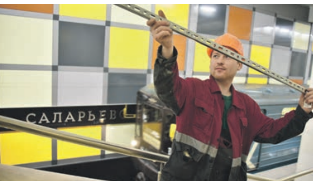
30 января 2016 года 09:27 Монтажник Павел Колесников работает на «Саларьево» с прошлого года. В его ведении — проверка систем безопасности на станции
